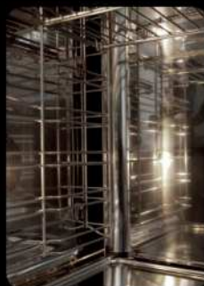
ZAKRĄGLONE KRAWĘDZIE KOMORY PIECA
